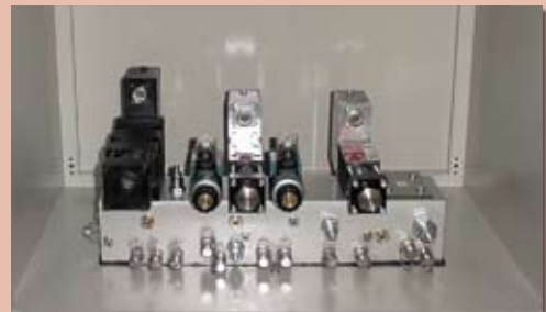
Válvulas hidráulicas montadas en un armario separado de la máquina
